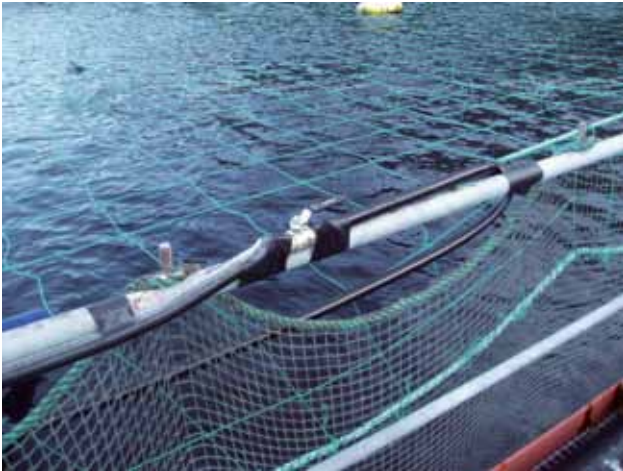
Bilde 5. Viser trykkventil ved hvert enkelt bur
